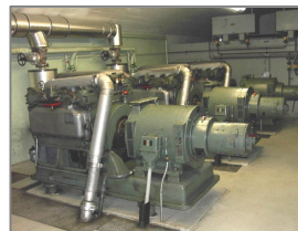
Motorenraum mit 3 Sulzerdiesel
